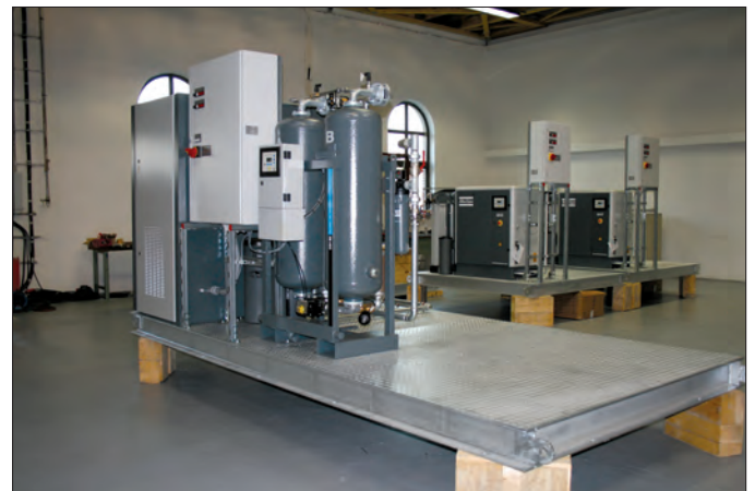
AIRCO plant nach Kundenwunsch, baut, installiert, wartet und repariert alle Anlagen zur Druckluft-, Stickstoff- und Sauerstoffherzeugung
